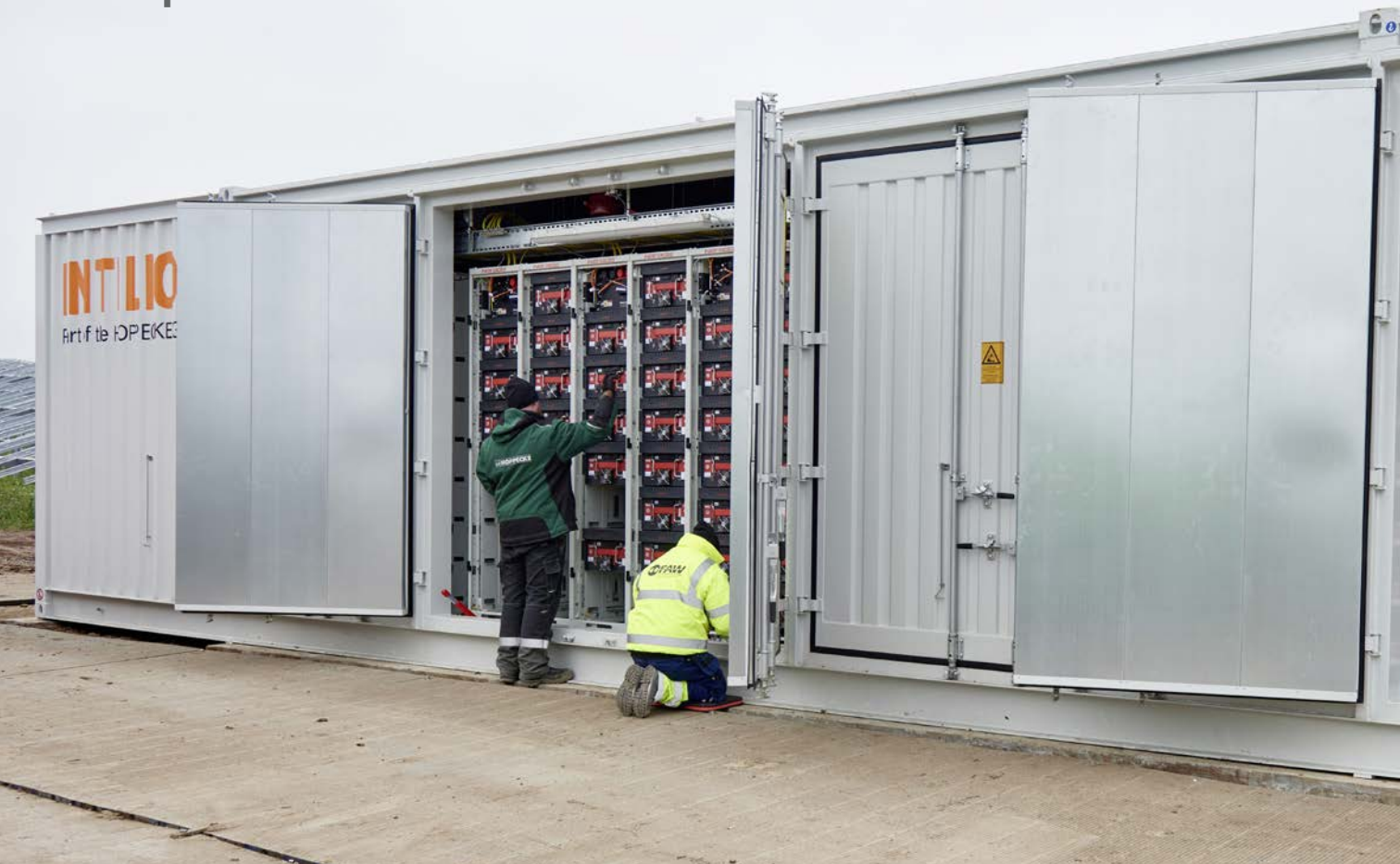
Intilion-Speicher für Projekte von Maxsolar in Unterfranken.
